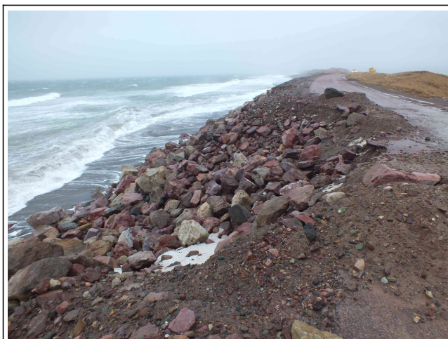
Effondrement amont sur la partie digue
